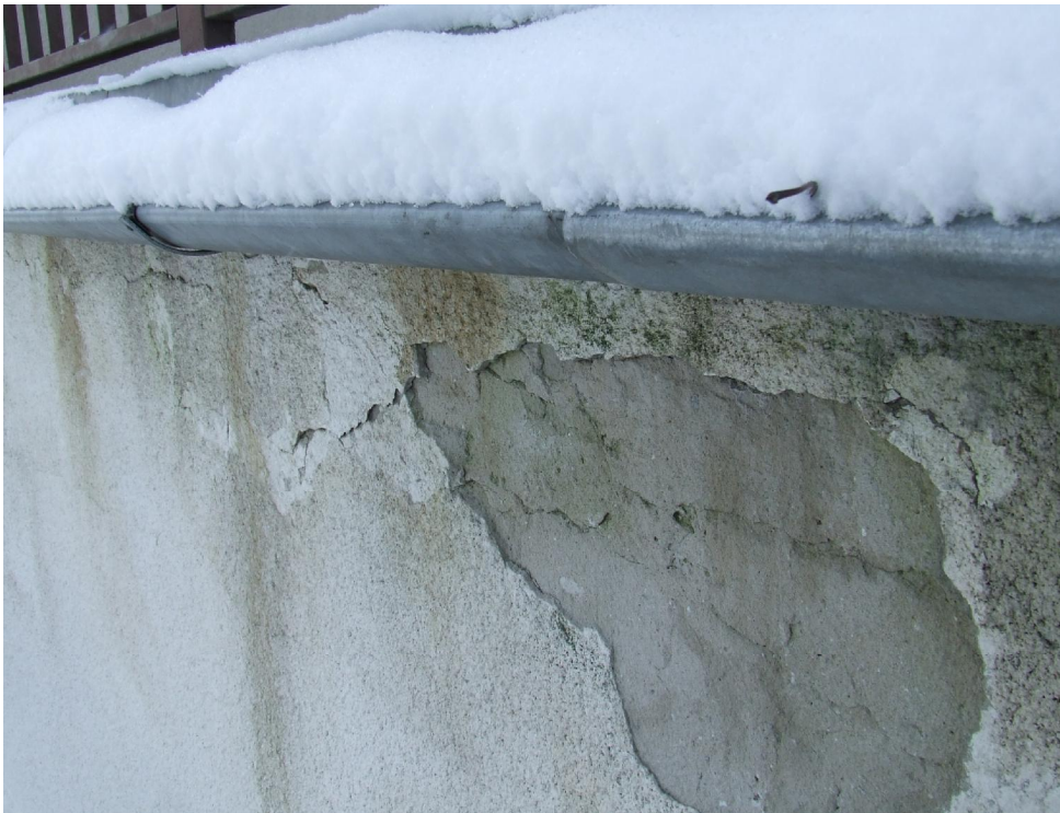
Zdjęcie: 6 Uszkodzenie tynku na elewacji
