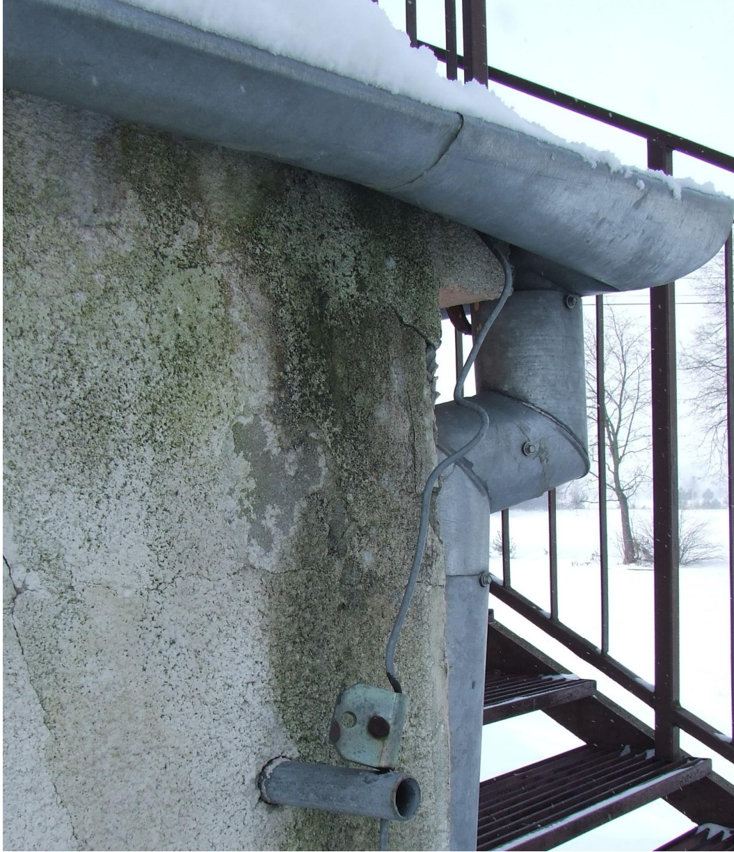
Zdjęcie: 7 Widoczny zaciek z nieszczelnych obróbek blacharskich.
